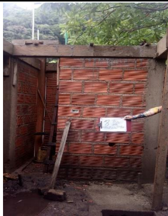
F.4: Caja de Inspección y Lavadero
