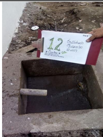
F.2: Caja de Inspección
