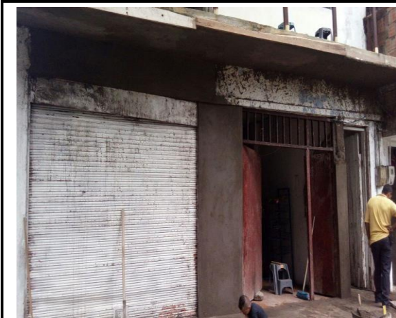
F.5: Fachada principal pañetes
