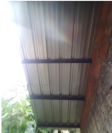
F.4: Alero sobre pasillo existente que conduce al patio interior de la casa, se aprecia cuchilla nueva.
