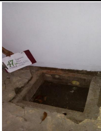
F.2: Caja de Inspección
