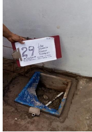
F.2: Caja de Inspección
