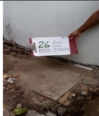
F.2: Caja de Inspección
