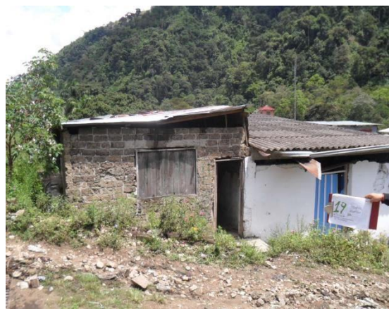
F.6: Fachada principal a pañetar y a pintar
