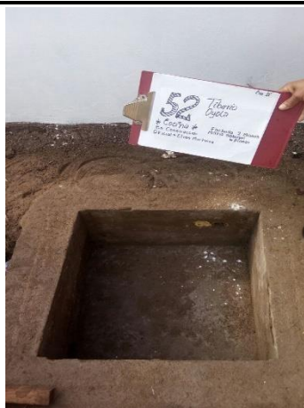
F.3: Caja de Inspección
