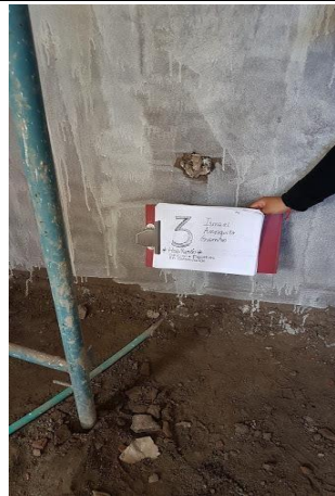
Foto No. 2: Inst. electricas
